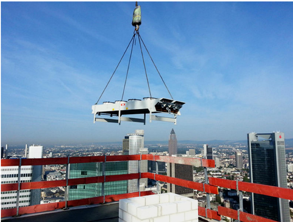
Abbildung 1: Ein Trockenkühler wird per Kran auf ein Dach gehoben.
